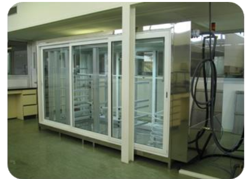
Sistemas de distribución de fluidos
